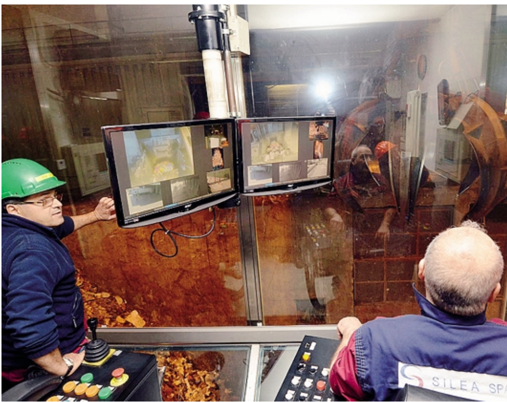
Il centro di controllo del forno inceneritore di Valmadrera
