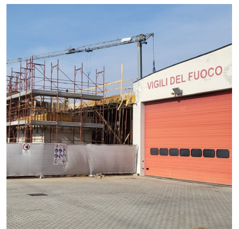
Il cantiere di via degli Alpini fermo dal 2023
